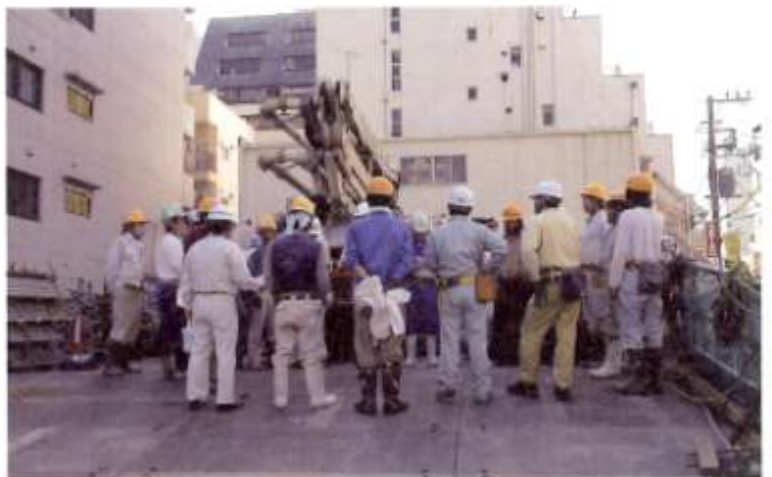
打設前の打ち合わせのようす。発注者は打設当日にも現場に顔を出すなど、作業員と共にコンクリートをつくる姿勢でいることが大切だ
