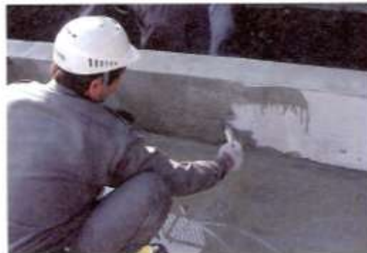
水ガラス塗布作業。表面をガラス質にし、耐久性を向上させる
