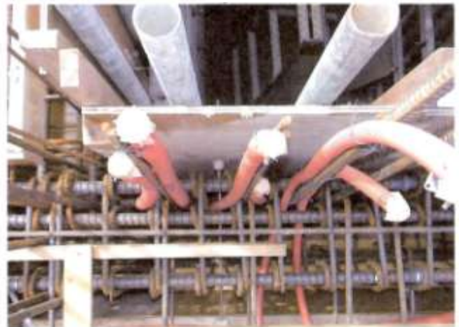
桧木が飛び出しているためにバイブレーターを挿入するすき間がない。コンクリートの密度を高める作業ができない
