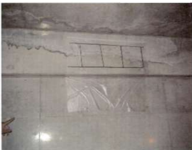
床面に認められる打ち継ぎ部、コールドジョイントの恐れがある
