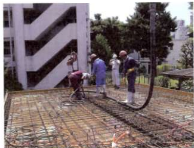
スラブ18の軟らかい生コンを、口径の小さいバイブレーター2本で打設
