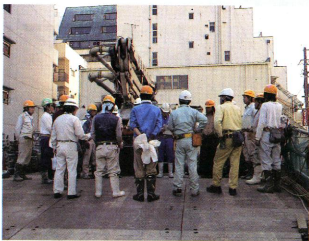
耐久なコンクリートを作るための、打設前に入念な打ち合せ。施主は必要な予算や工期について理解し、作業員が気持ちよく作業できる環境づくりをすることが大切
