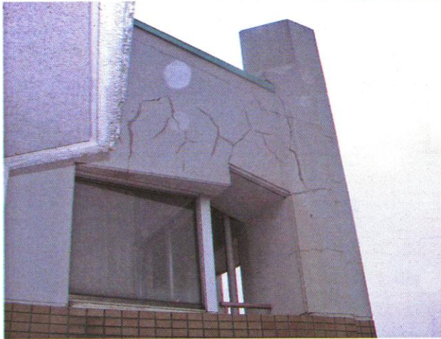
ひび割れが入った鉄筋コンクリート造のマンションの外壁。ひび割れはコンクリート内の水分が蒸発して乾燥し、収縮することで起きる
