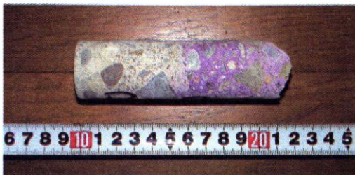
躯体からくり抜き採取したコンクリートにフェノールフタレイン溶液をかけてみる。右側の赤紫の部分はアルカリ性であることを示し、左側の変色していない部分は、中性化していることを示す
