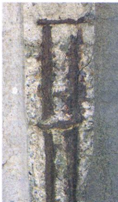
さびた鉄筋がむき出しになったコンクリート。鉄筋がさびて膨張することでコンクリートを押し出し、ひび割れやはく離を招く
