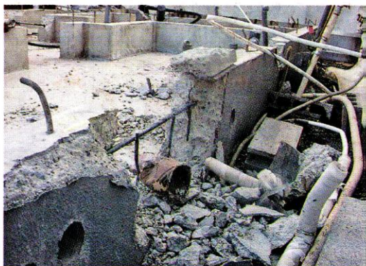
住宅の基礎を取り壊しているところ。水分の多い生コンを雑に施工し、養生も行なわなかったために、ひび割れが多量に発生した
