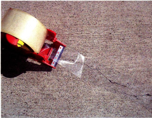
ひび割れを見つけたら、補修までの間、テープを張り付けておく。そうすることでひび割れの進展、コンクリート内部の鉄筋の腐食を防ぐことができる
